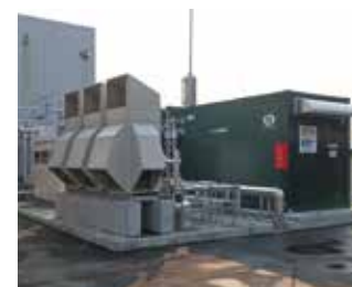
「ヒートポンプとバイオガス発電の併用運転による熱変換貯蔵」実証設備
